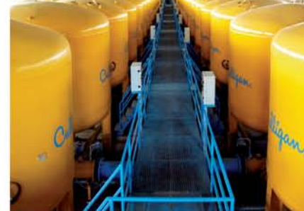
Potabilizzazione e rimozione Arsenico Potabilisation and Arsenic removal
